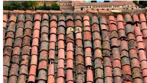
Tejas rotas y mal dispuestas
