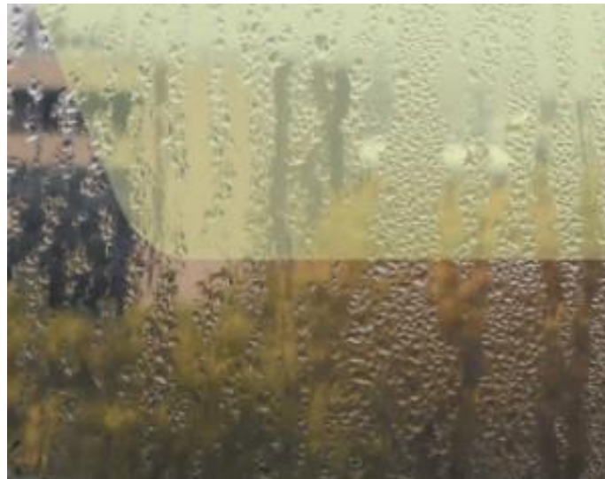
Apariencia de la humedad de condensación
