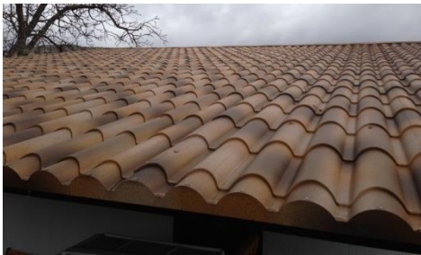
Cubiertas sin volado suficiente y sin canaleta.
