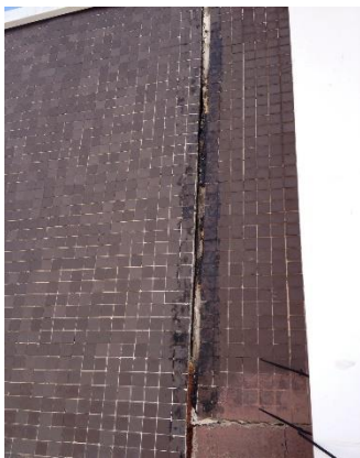
Juntas de fachada mal tratadas
