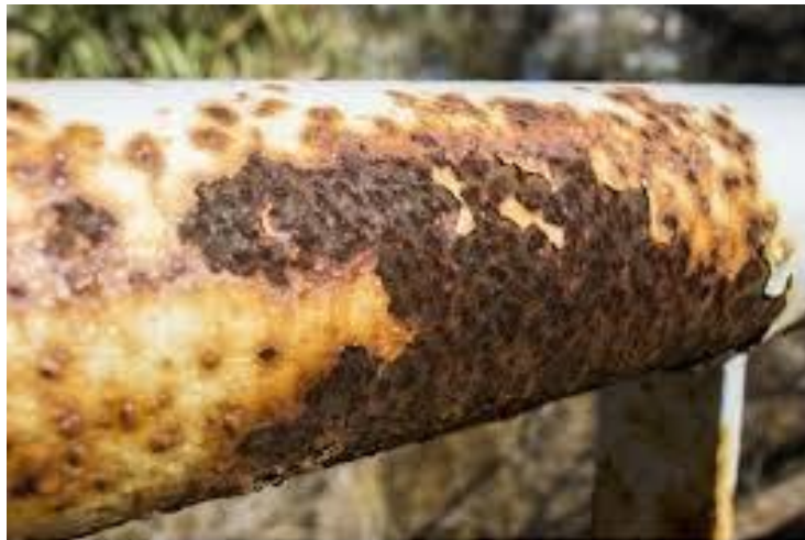
Corrosión de los conductos metálicos.
