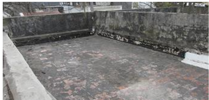
Cubierta plana sin impermeabilizar
