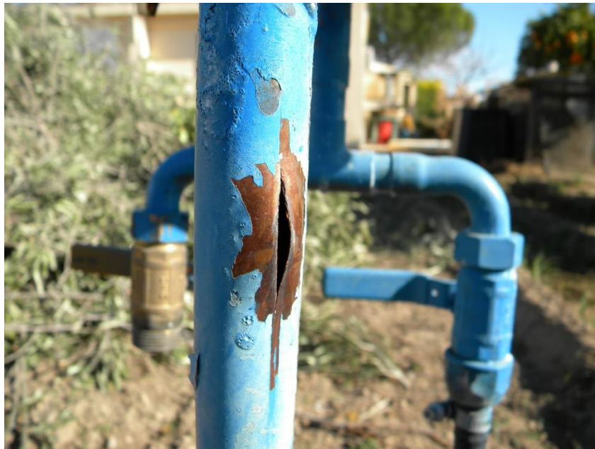
Rotura de tubería accidental.
